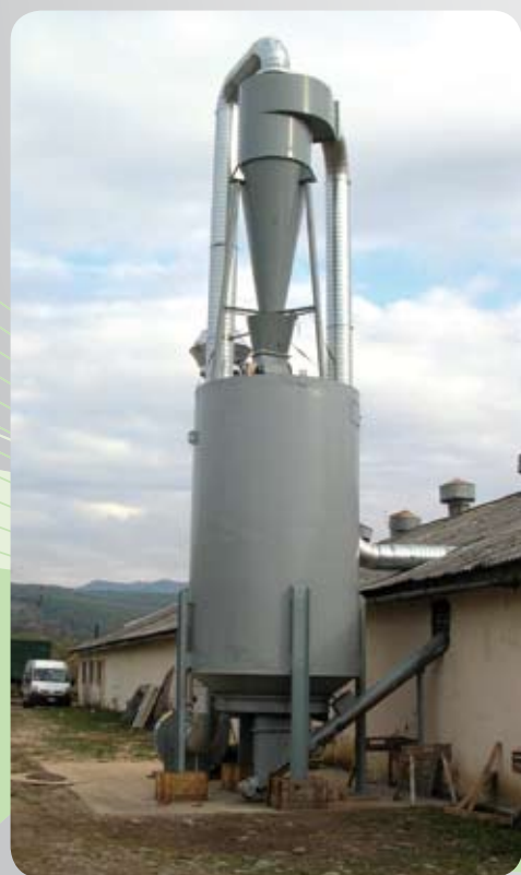
Ciclone e silo materiale secco Cyclone and silo
