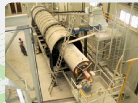
Essiccatore 11 Mw termici Dryer 11 Mw
